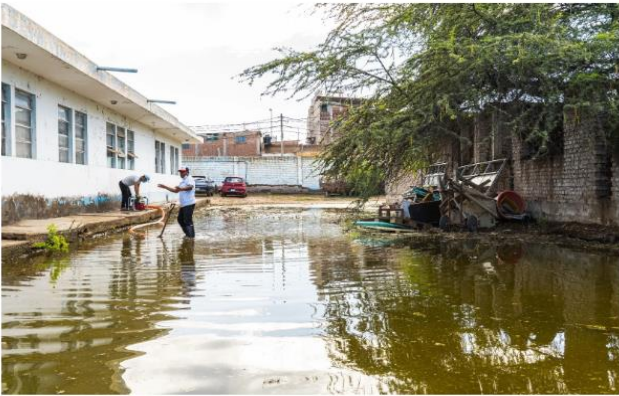
En marzo de este año, durante El Niño costero, el Hospital Referencial de Ferreñafe en Lambayeque quedó inundado por las lluvias y la falta de sistemas de drenaje.
